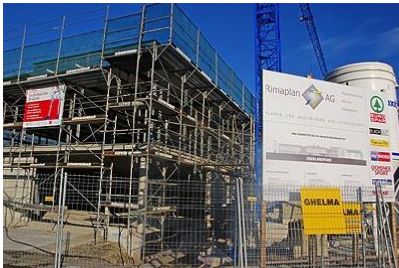
Die Frontseite des Neubaus: Jetzt ist er unter Dach. Fotos: Anne-Marie Günter
