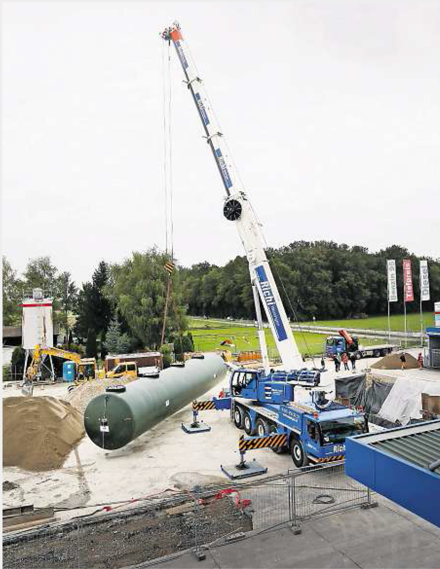
Hier ist ein ruhiges Händchen gefragt: Der Kranführer versenkt den 26 Tonnen schweren Riesentank auf den Zentimeter genau in der engen Grube.
